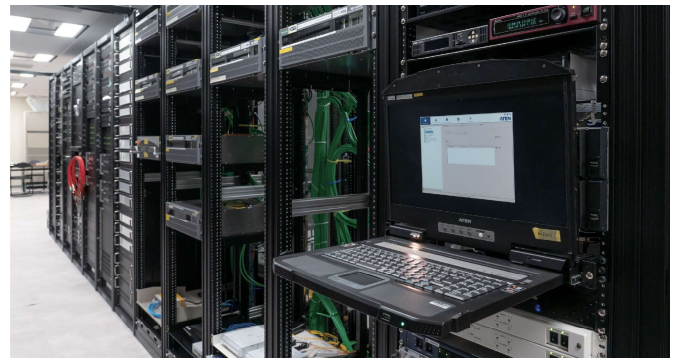
▲ サーバルーム内でも ATEN のドロワーを用い、サーバーを操作
