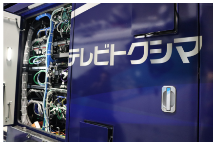
▲中継車のサーバラック内機器
