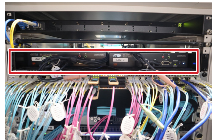
▲サーバールーム内：ATENの延長機KE6900AIT（送信機）
