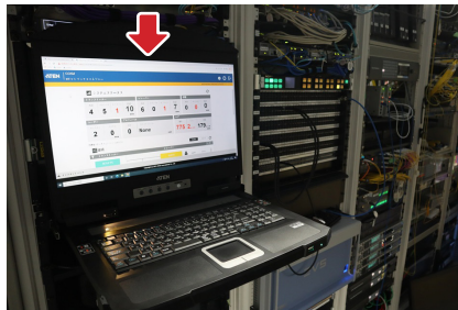
▲サブの隣にあるサーバールーム内：サーバ管理に ATENのドローとCCKMが利用されている。
